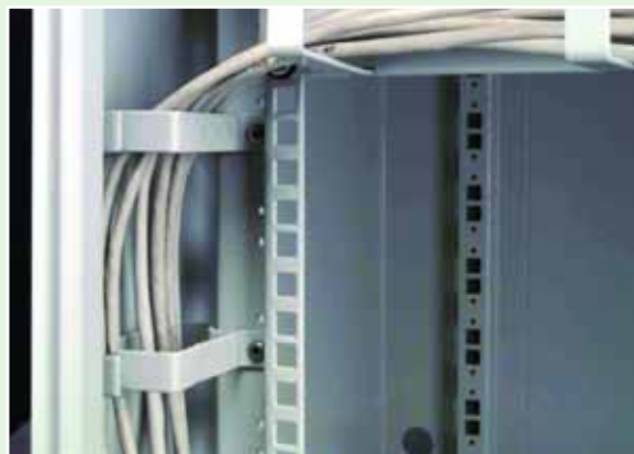
Prowadzenie przewodów w szafce za pomocą uchwytów kablowych
