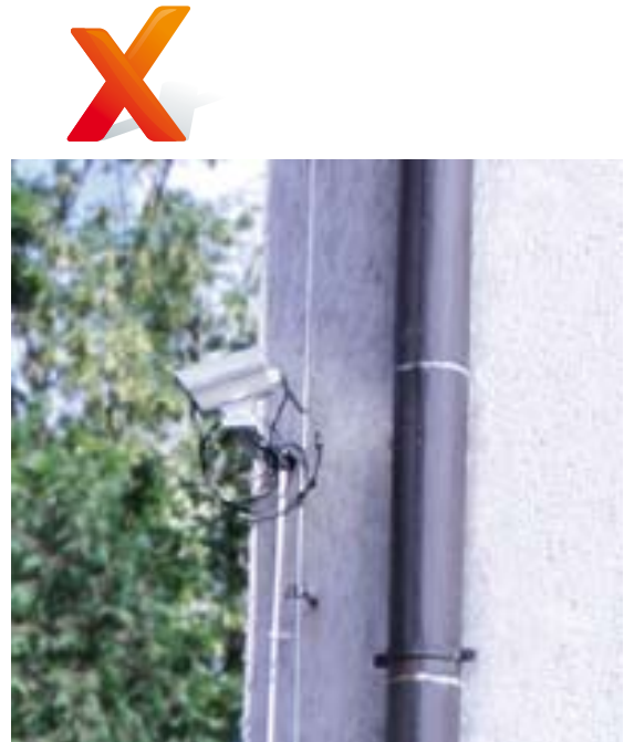
Rys.9 Przykład nieprawidłowego montażu kamery monitoringowej przy instalacji odgromowej. Brak zachowania bezpiecznego odstępu izolacyjnego.
